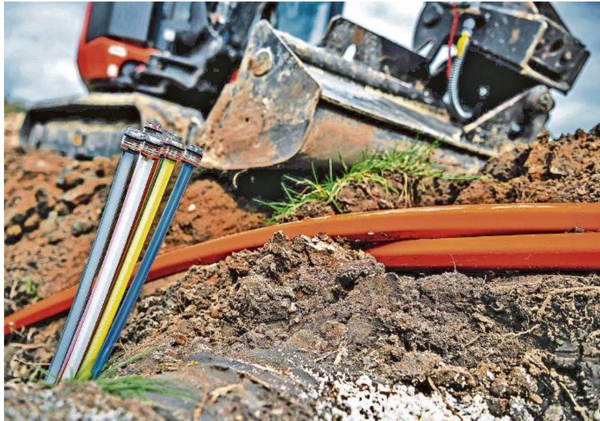
Während die Glasfaserkabel in Mühlacker und den Stadtteilen verlegt werden, kommt es zu temporären Einschränkungen durch die Bauarbeiten. SYMBOLBILD: SINA SCHULTZ/DPA
