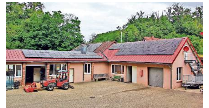
Der Maulbronner Bauhof verfügt nun über eine frisch installierte Photovoltaikanlage auf den Dächern. FOTO: ULRIKE FEGERT/STADT MAULBRONN
